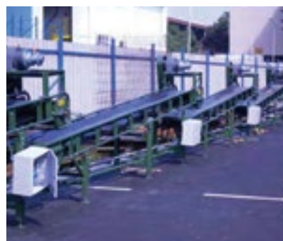
⑦ 土砂搬送コンベヤ (エアーモータ)
