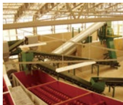
① 鶏糞搬送設備
