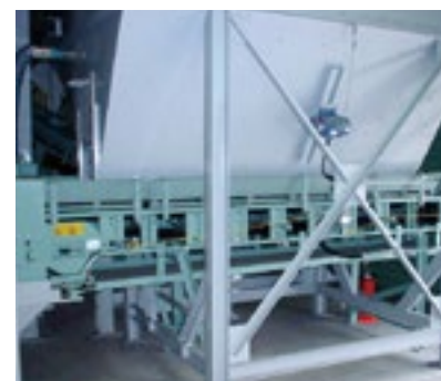
③ 肥料搬送コンベヤ
