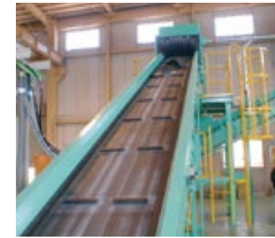
② ブラウン管破砕物設備
