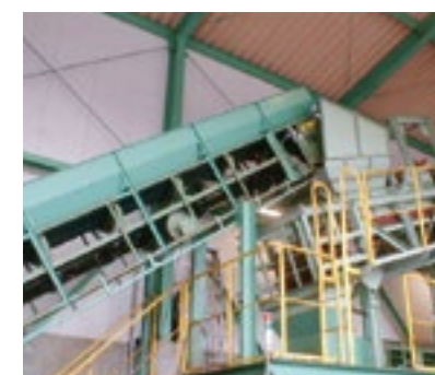
⑪ ゴミ搬送コンベヤ
