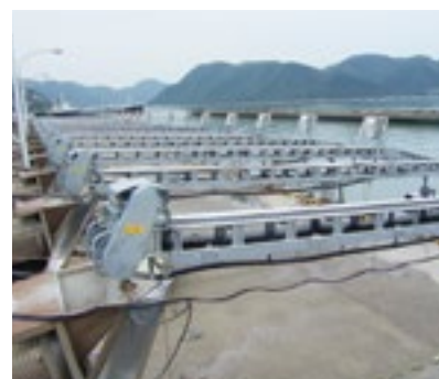
② かき搬送コンベヤ
