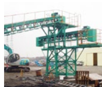
④ 解泥土壌設備
