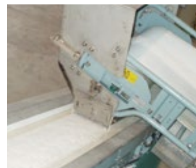
⑨ 塩搬送コンベヤ
