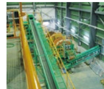
⑥ 解泥土壌搬送設備
