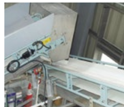
⑥ 塩搬送コンベヤ
