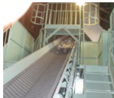
⑤ アルミ廃材搬送コンベヤ
