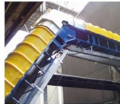
③ 豆炭搬送コンベヤ
