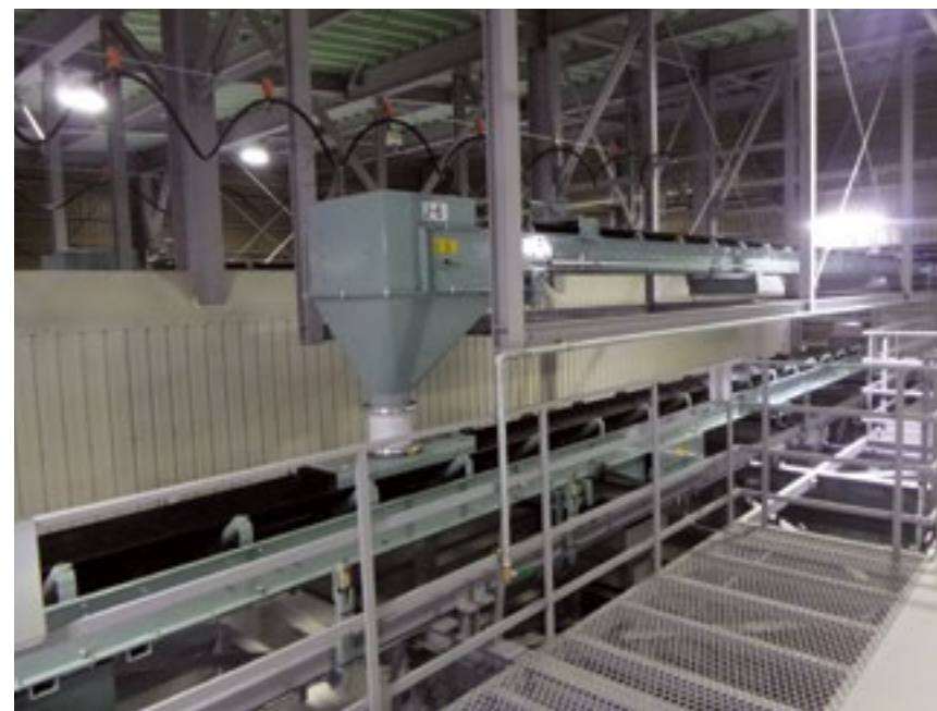
⑨ 穀物搬送コンベヤ
