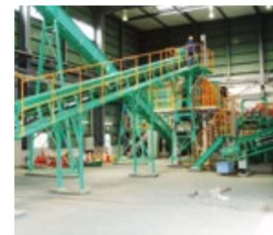
⑤ 解泥土壌搬送設備
