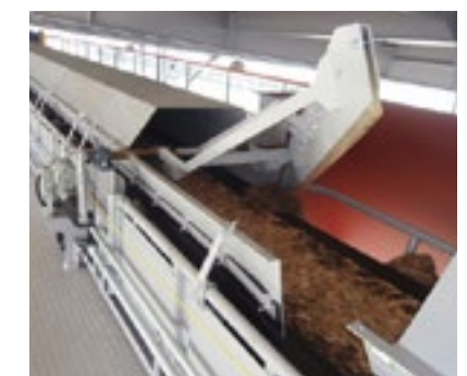
⑫ 中間払出装置
