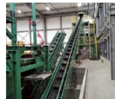
⑧ 廃家電搬送設備
