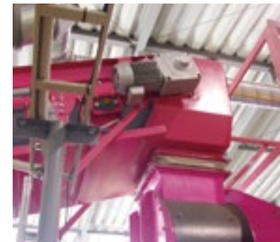
④ カレット搬送コンベヤ
