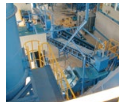
② 不燃物・可燃物搬送コンベヤ
