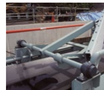
⑪ 中間払出装置
