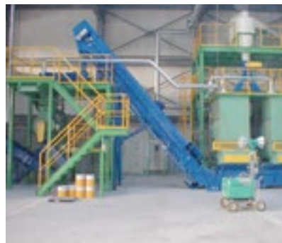
④ 紙・廃プラスチック搬送設備
