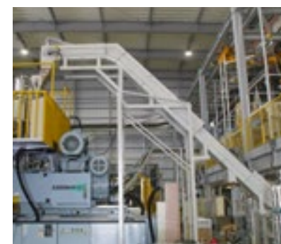
⑩ プラスチック材料搬送コンベヤ
