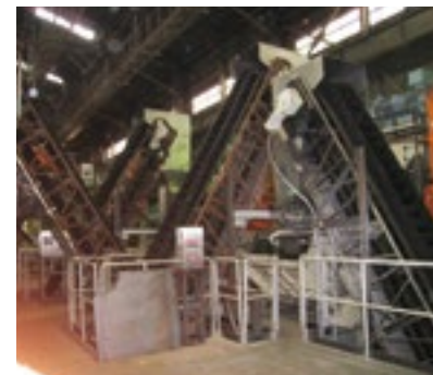
⑥ 原料搬送設備（急傾斜コンベヤ）
