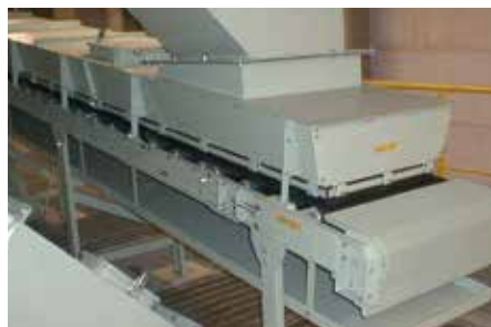
選別ごみ搬送コンベヤ
