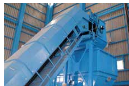
建設廃材設備
