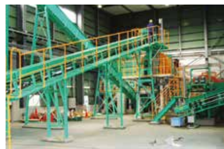
解泥土壌搬送設備
