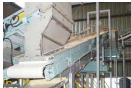
塩搬送コンベヤ
