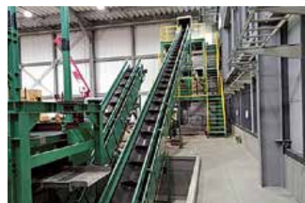
廃家電搬送設備
