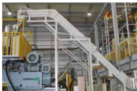
プラスチック材料搬送コンベヤ
