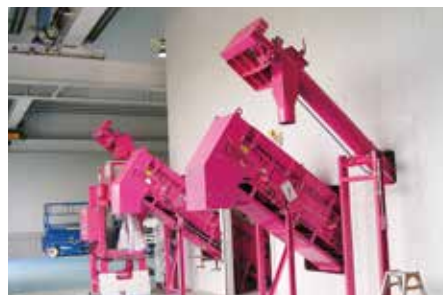
カレット搬送コンベヤ
