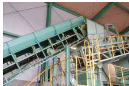
ゴミ搬送コンベヤ
