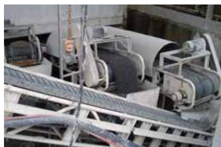
砂・砂利搬送コンベヤ
