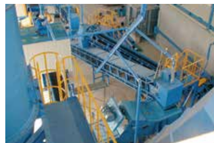
不燃物・可燃物搬送コンベヤ
