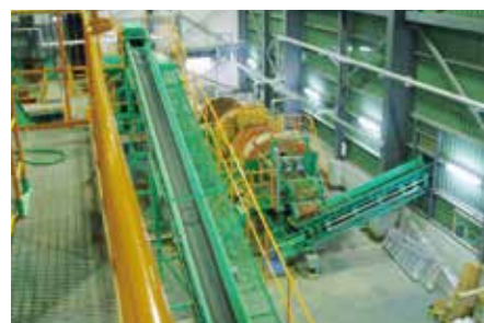
解泥土壌搬送設備
