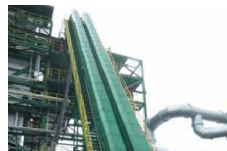
バイオマス発電燃料供給コンベヤ
