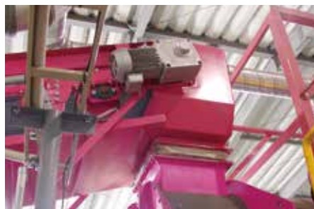
カレット搬送コンベヤ
