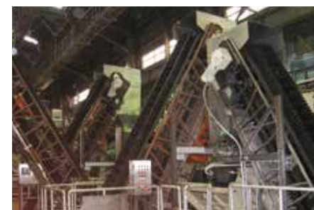
原料搬送設備(急傾斜コンベヤ)
