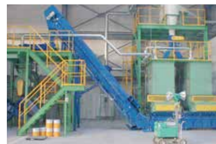
紙・廃プラスチック搬送設備
