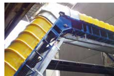
豆炭搬送コンベヤ
