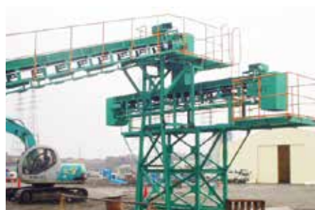
解泥土壌設備
